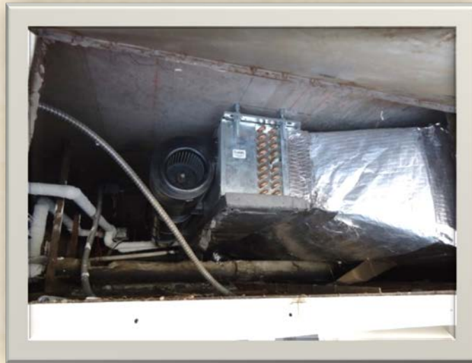
Figura 129. Equipos de refrigeración reemplazados.
